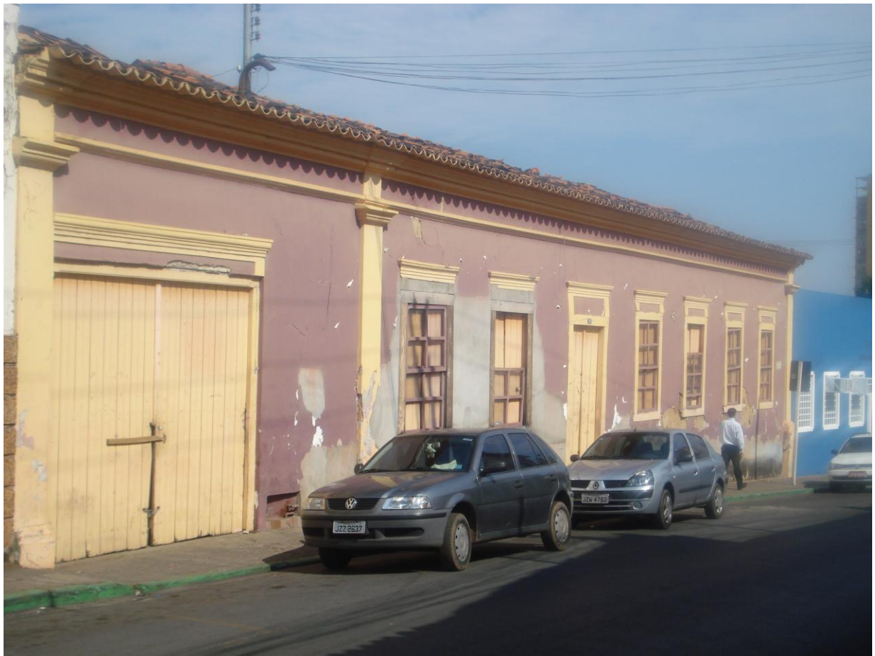
Foto 8 – Prédio Particular resistindo às intempéries
