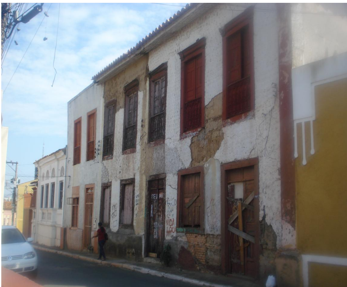
Foto 6 – Prédios Particulares em risco de demolição
