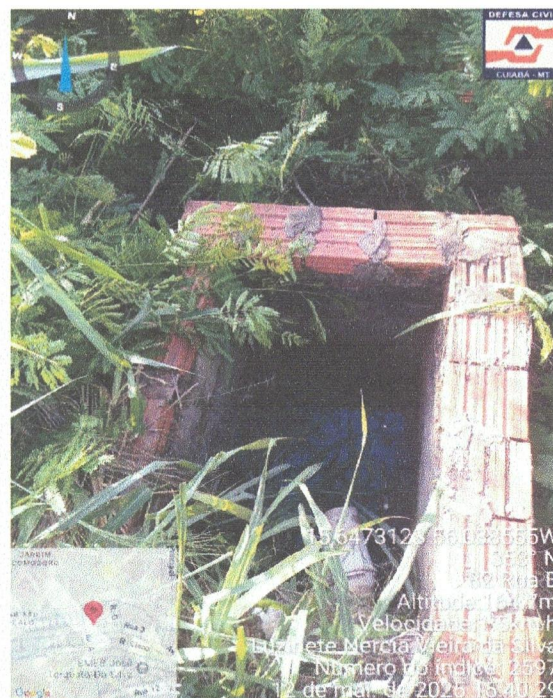
Figura 10. Caixa de passagem.
