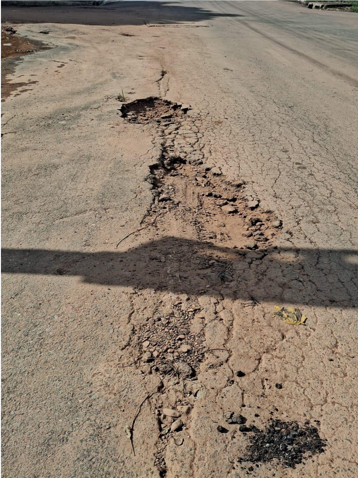
Serviço de tapa buraco na Avenida Arquimedes Pereira Lima, no trecho compreendido entre o Bairro Pedregal e o Bairro Leblon, em frente ao prédio NYC.
