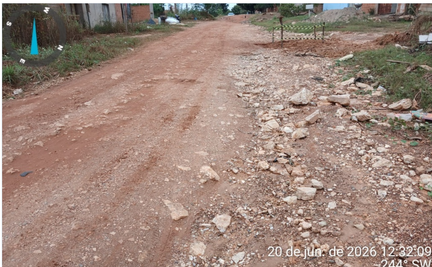
Registro das condições do pavimento e pedras soltas na via pública.
