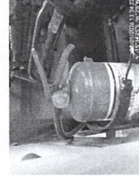
Extintor de incêndio despressurizado
